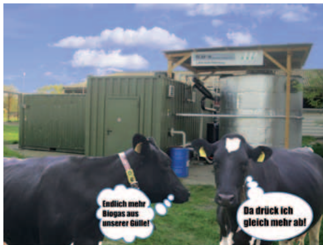
Obr. 5 – BCM-Biogasentwicklungszentrum Lutherstadt Wittenberg, Německo
