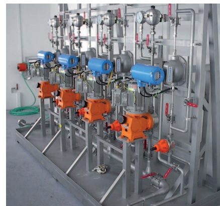
Obr. 2 – Měření průtoku methanolu hmotnostními průtokoměry OPTIMASS za dávkovacími čerpadly
